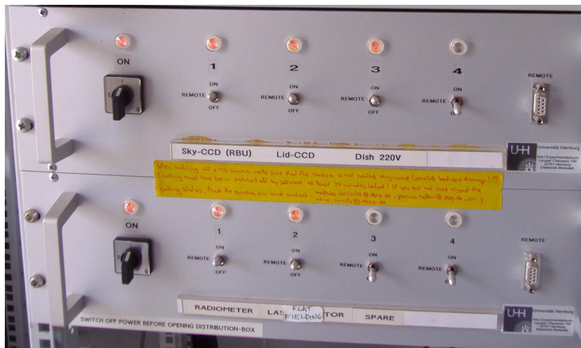
Abbildung 4.18: Die Steuerungseinheit in der Elektronikhütte für die Stromversorgung am Teleskop: Zu sehen sind die Fernschalter ( REMOTE ) zum Ein- und Ausschalten von Komponenten am Teleskop. Damit werden LidCCD und SkyCCD ein- und ausgeschaltet (oben links). Rechts sind zwei bisher unbelegte Schalter. [Photo: H.-S. Zechlin, Dezember 2009]
